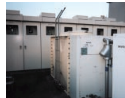
氷蓄熱設備(本社)
