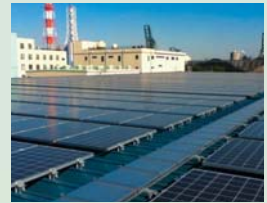
日清製粉 鶴見工場の太陽光パネル
