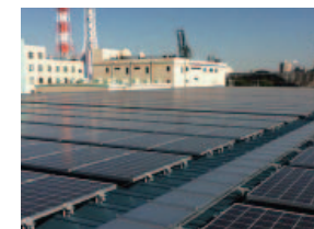
日清製粉 鶴見工場の太陽光パネル
