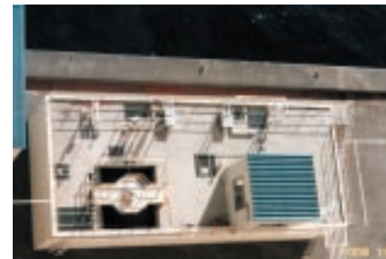
工場排水処理設備(鶴見工場)
