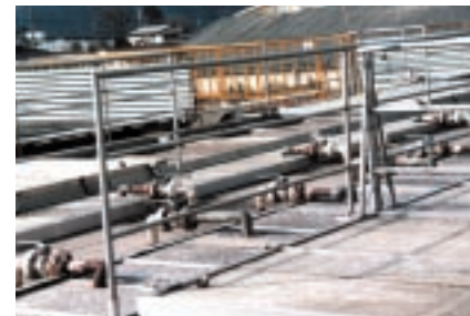
生産排水処理設備(上田工場)
