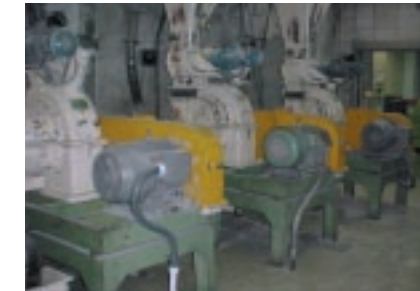
再利用設備(鶴見工場)
