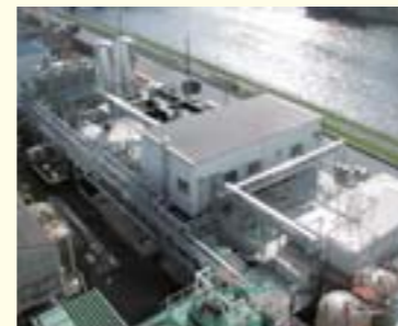
オリエンタル酵母工業の排水設備
