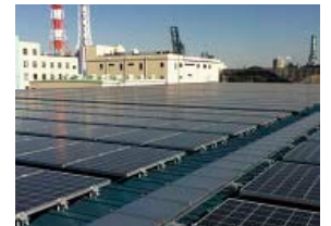
日清製粉 鶴見工場の太陽光パネル
